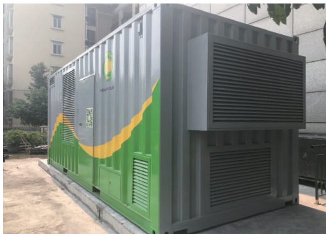
江门数据中心
